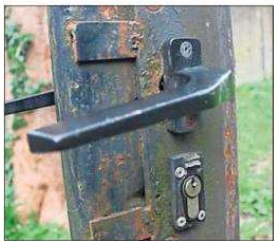
Der schlechte Zustand ist schon auf den ersten Blick zu sehen: Rost breitet sich aus.
