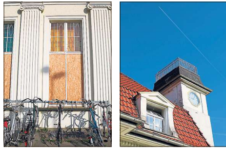
Kaputte Fahrräder stehen vor dem maroden Gebäude. Ein Silberstreif am Horizont ist derzeit nicht zu sehen.
