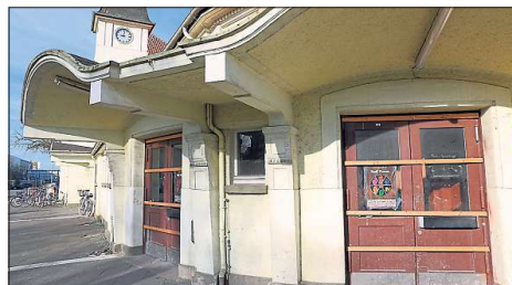
Kein Durchkommen gibt es zur Eingangshalle des ehemaligen Bahnhofsgeländes. Der desolante Zustand des Denkmals verärgert Bürger und Vereinsvertreter.
